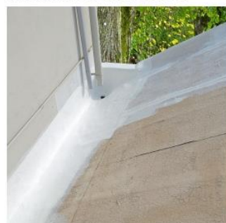
PLUVIALI SOGGETTI A RISTAGNO
